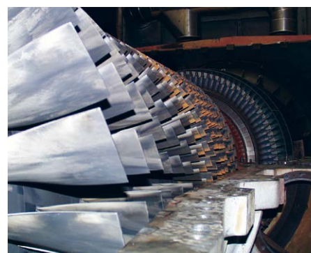
Turbinschaufeln FHKW Linz-Süd
