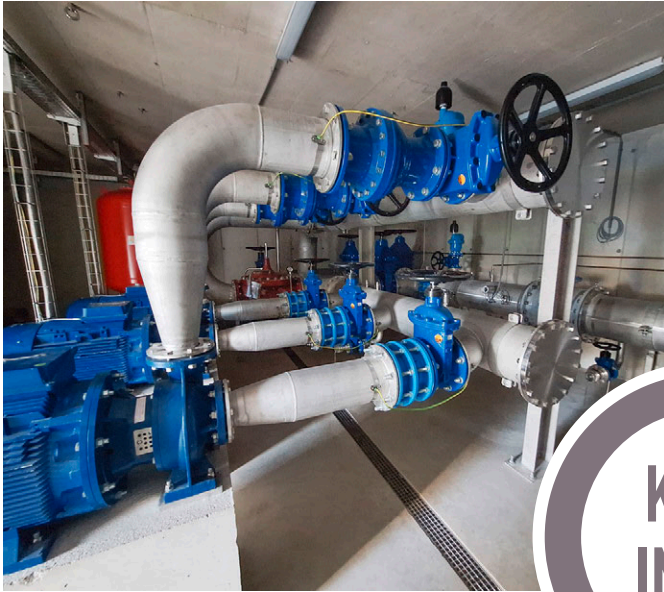
Die neue Druckerhöhungsanlage sichert die Wasserversorgung in Linz.
