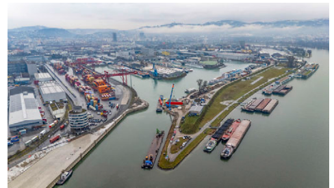
Die Bauarbeiten für „SAFE Port of Linz“ werden im Sommer abgeschlossen sein.
