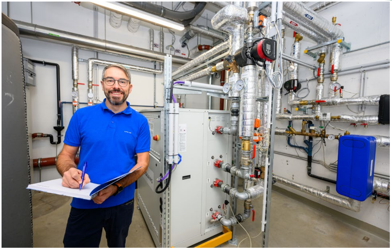
In der Blutzentrale – Rotes Kreuz Oberösterreich wurde von der LES ein umfassendes Dekarbonisierungsprojekt mit PV-Anlage, LED und Wärmerückgewinnung via Wärmepumpe umgesetzt. Am Bild: Herbert Fernbach, MSc. Fotorechte: LINZ AG/Fotokerschi
