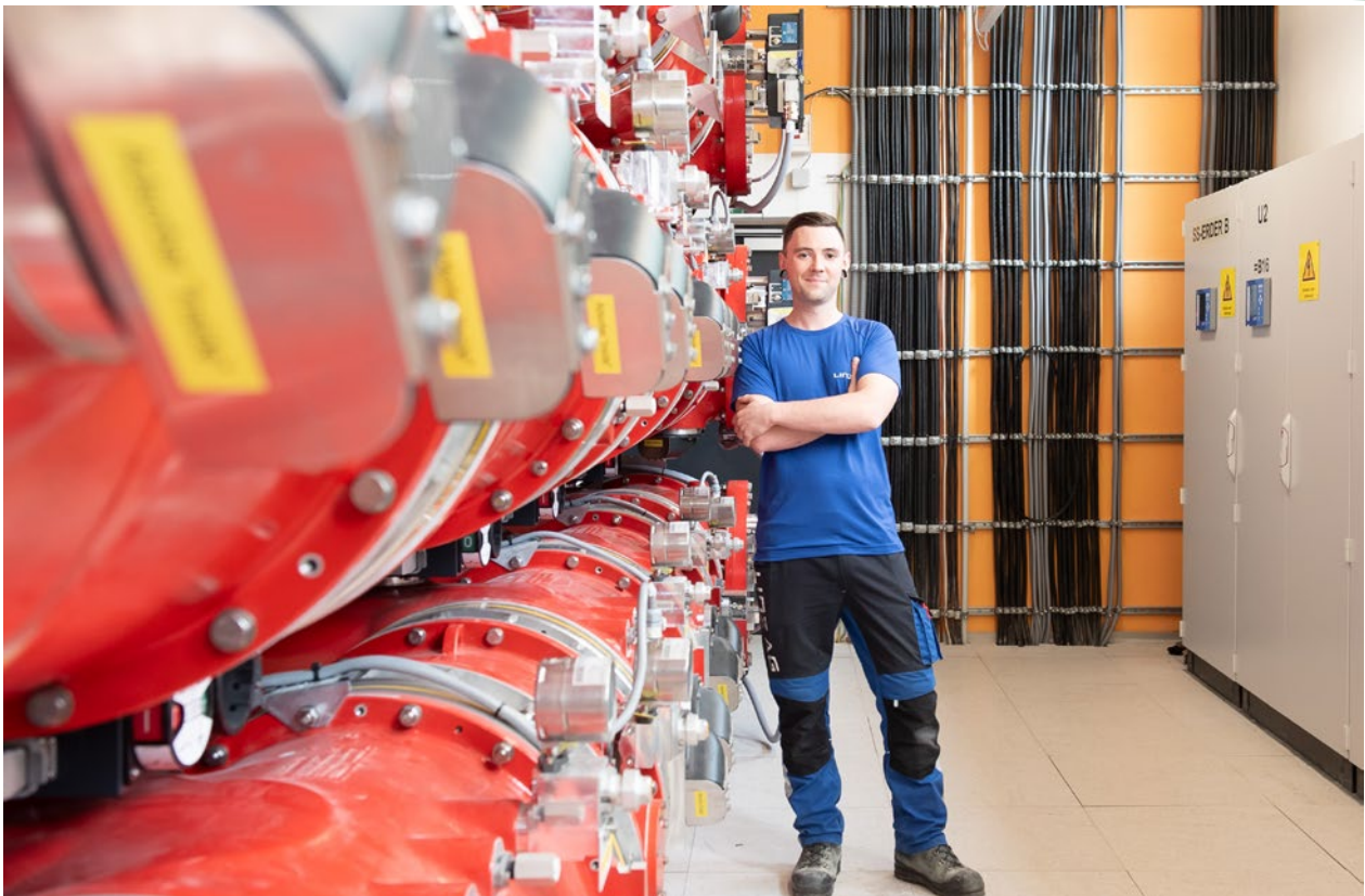
Monteur Marc Oertel – hier im Umspannwerk Pichling – und seine Kolleg*innen von der LINZ NETZ GmbH zählen zu den Ermöglicher*innen der Energiewende. Fotorechte: LINZ AG/doris-reinthal.com
